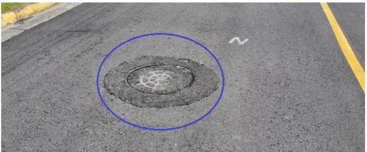
Imagen 5. Levantamiento de tapas de pozos.
