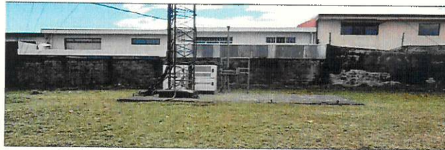
Foto actual de la antena provisional CT0013.
