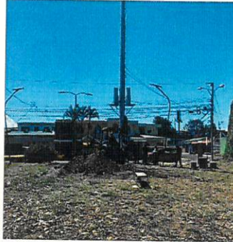
Foto de la antena instalada bajo el permiso 24-F-2020, CT0161.
