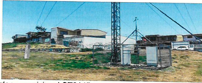
Foto actual de la antena provisional CT0145.
