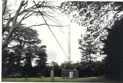
Foto actual de la antena provisional CT0143.
